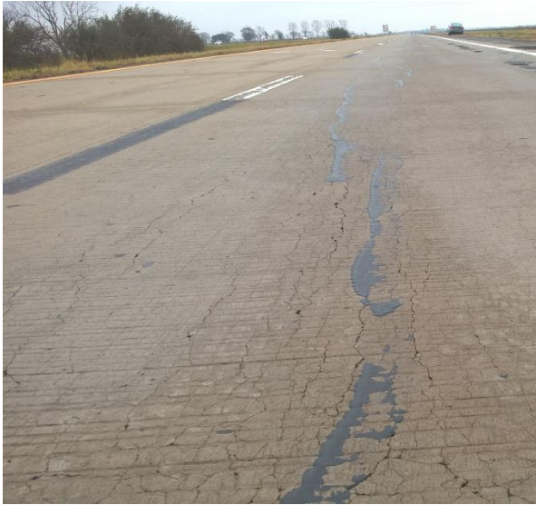
Figura 3: Mapeo y propagación longitudinal de fisuras sobre huella de tránsito pesado de una calzada de hormigón de menos de 10 años. [M.González, 2018]
