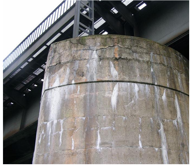
Figura 4: Patrón rectangular sobre armaduras y geles exudados carbonatados sobre el pilar de hormigón de un puente [Forschung, HTW wisend, 2013]
