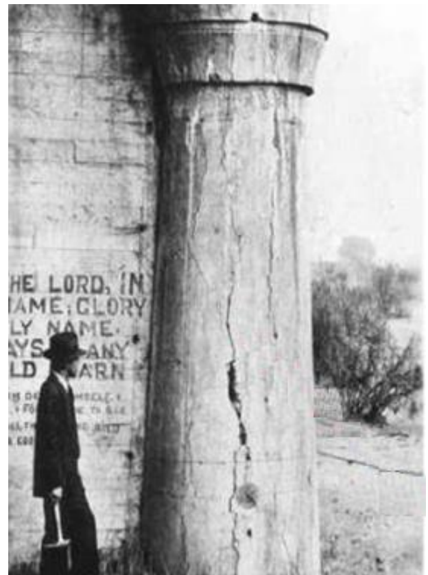
Figura 2: Fisuras longitudinales en la columna de un puente de hormigón afectado por RAS.
